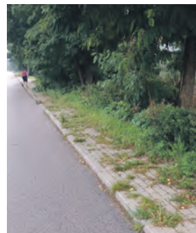
Chodnik w Dobrej od dawna pozostaje w złym stanie.
