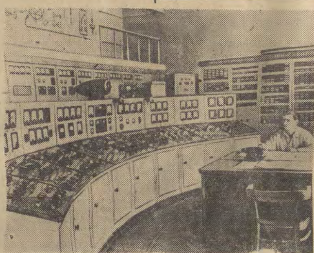
A oto stół rozdzielczy synchrocyklotronu.
