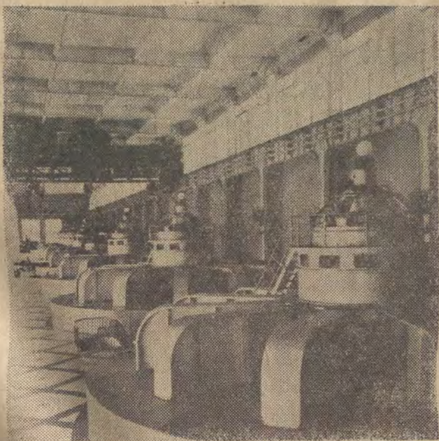
Na zdjęciu: w hali maszyn Dnieprowskiej Elektrowni Wodnej im. Lenina. Fot. — CAF
