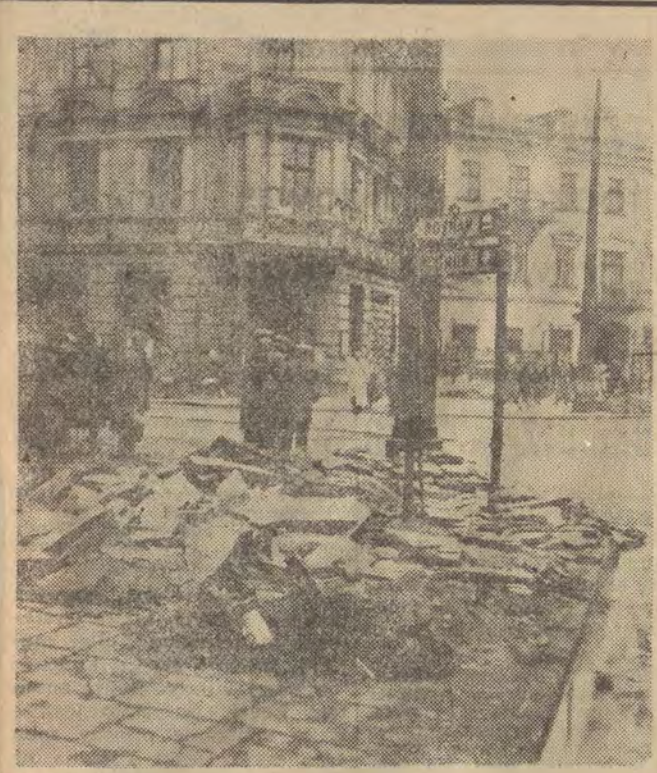
Od kilku tygodni na chodnikach Pl. Wolności leżą sterty porabianego asfaltu, które psują krew wszystkim przechodniom. — Tylko nasi łódzcy „wykopkowie” uważają że „wszystko jest w porządku”. (Do felietonu niżej)
