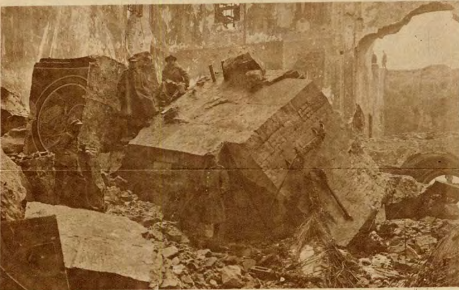
Dla przyspieszenia rozbiórki soboru na Placu Saskim, postanowiono przy pomocy materiałów wybuchowych zwalić 4 kolumny granitowe i tym sposobem podważyć sklepienie. Zdjęcie nasze przedstawia granitowe brzyty sklepienia, zwalone wybuchem, leżące na wysokość paru pięt na posadzce soboru.
