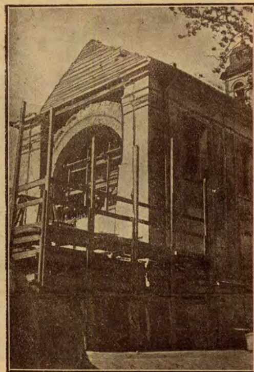
Odnawianie historycznego kościołka na Woli, w którym w 1831 r. poległ generał Sowiński.
