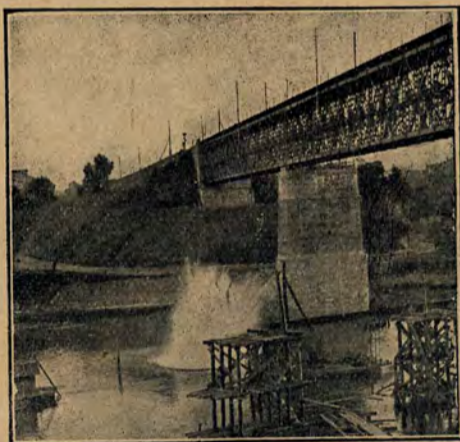
Wysadzenie filaru starego mostu. W głębi nowy most kolejowy, zbudowany przez Niemen w 1923 r.
