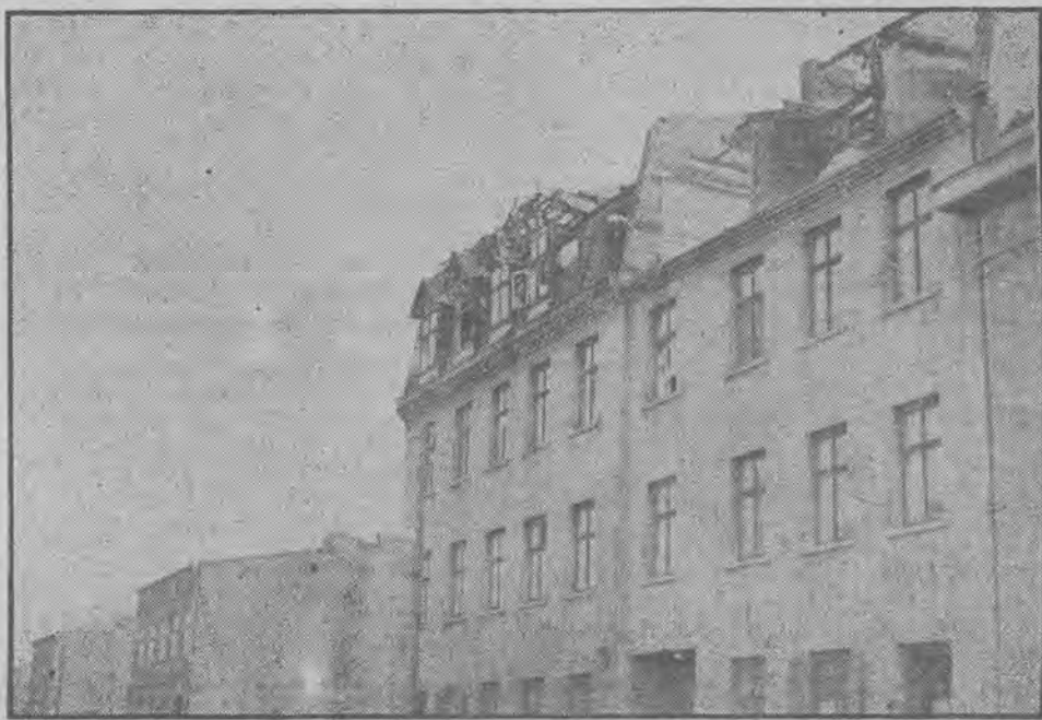
Dom w Łodzi przy ul. Wspólnej 9 zniszczony przez pożar. Wskutek pożaru siedem rodzin zostało bez dachu nad głowami. Są to przeważnie ludzie biedni.
