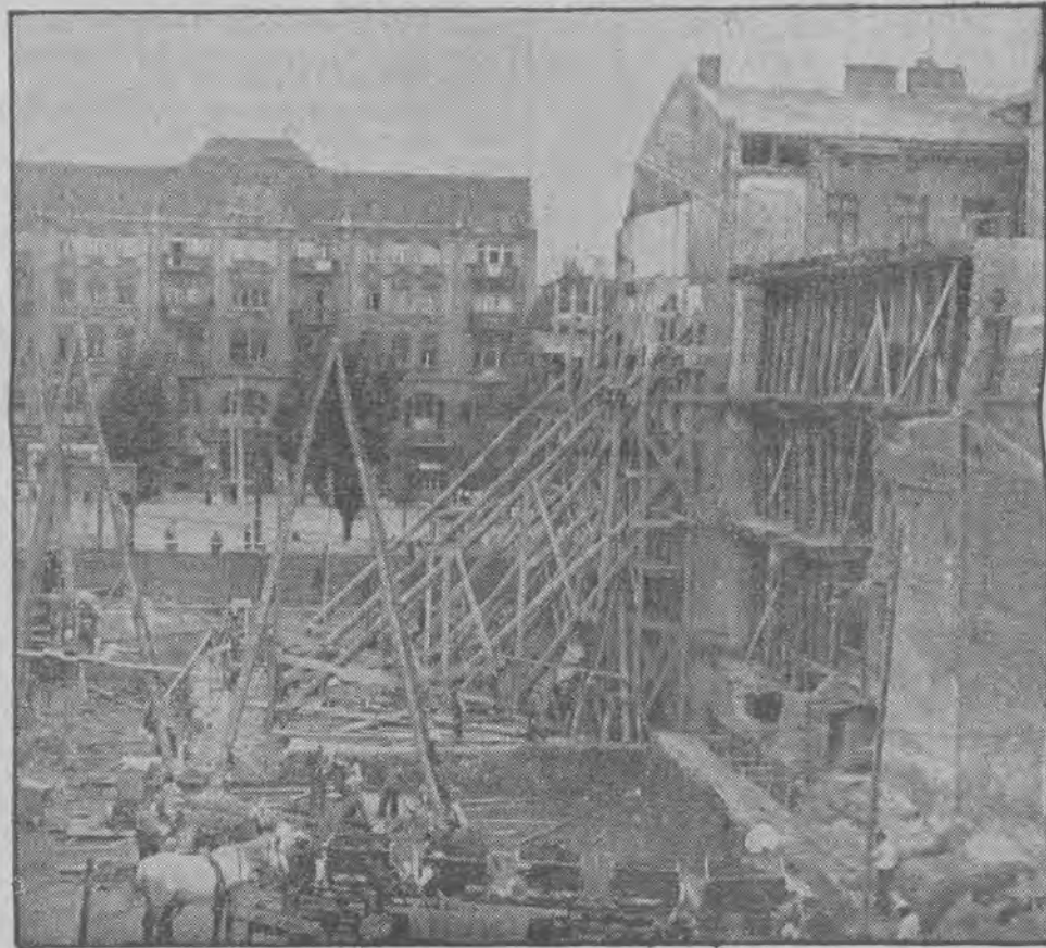
W Poznaniu przystąpiono przed miesiącem do budowy gmachu P. K. O. przy Pl. Wolności. W trakcie rozbierania delychczasowego gmachu i przy rozpoczęciu robót zarysowała się silnie ściana sąsiedniego domu przy Placu Wolności 2 tak, że władze zmuszone były zarządzić ewakuację mieszkańców domu. Szczyt zagrożonej zawaleniem kamienicy rozebrano w ub. tygodniu. Szczyty kamień przy Placu Wolności 2 i 4 mają w przyszłości otrzymać silniejsze i głębsze fundamenty. — Przy pracy nad przygotowaniem terenu pod budowę gmachu P. K. O. zatrudnionych jest 200 robotników. Na zdjęciu rozebrana ściana w posesji przy Placu Wolności 2 i teren objęty robotami.
