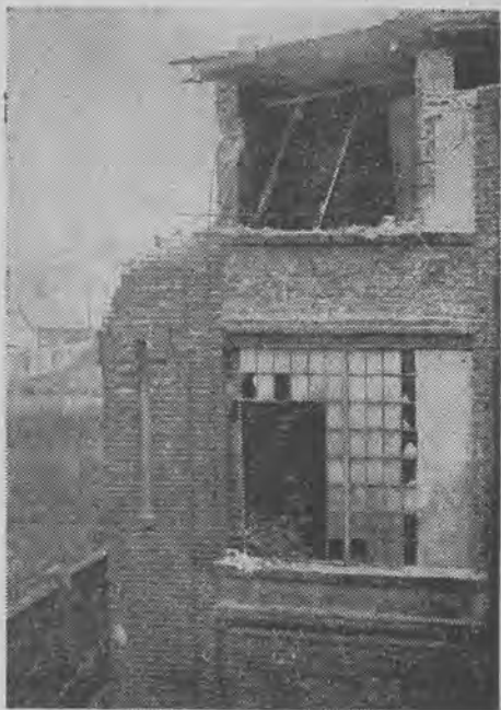
Przed trzema dniami w Łodzi we fabryce Zyda Laskowskiego wybuchł kocioł do centralnego ogrzewania. Przy wybuchu rany odniosło 10 robotników. Na zdjęciu zniszczona wybuchem ściana drugiego piętra fabryki.
