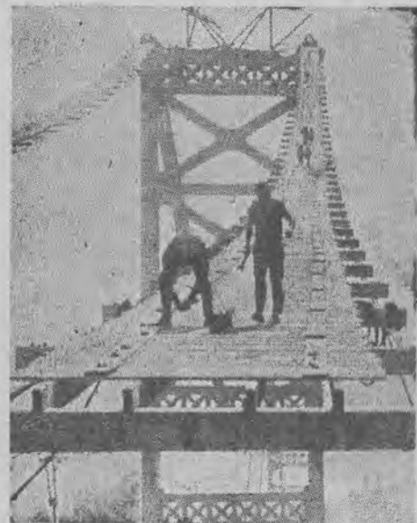
Budowa mostu wiszącego nie wymaga żadnych rusztowań. Na dwóch linach pomocniczych układa się chodnik z desek, który tworzy podstawę do dalszych prac nad konstrukcją mostu.
