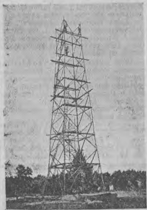
L. O. P. P. w Łodzi przystąpiła do budowy wieży do skoków spadochronowych
