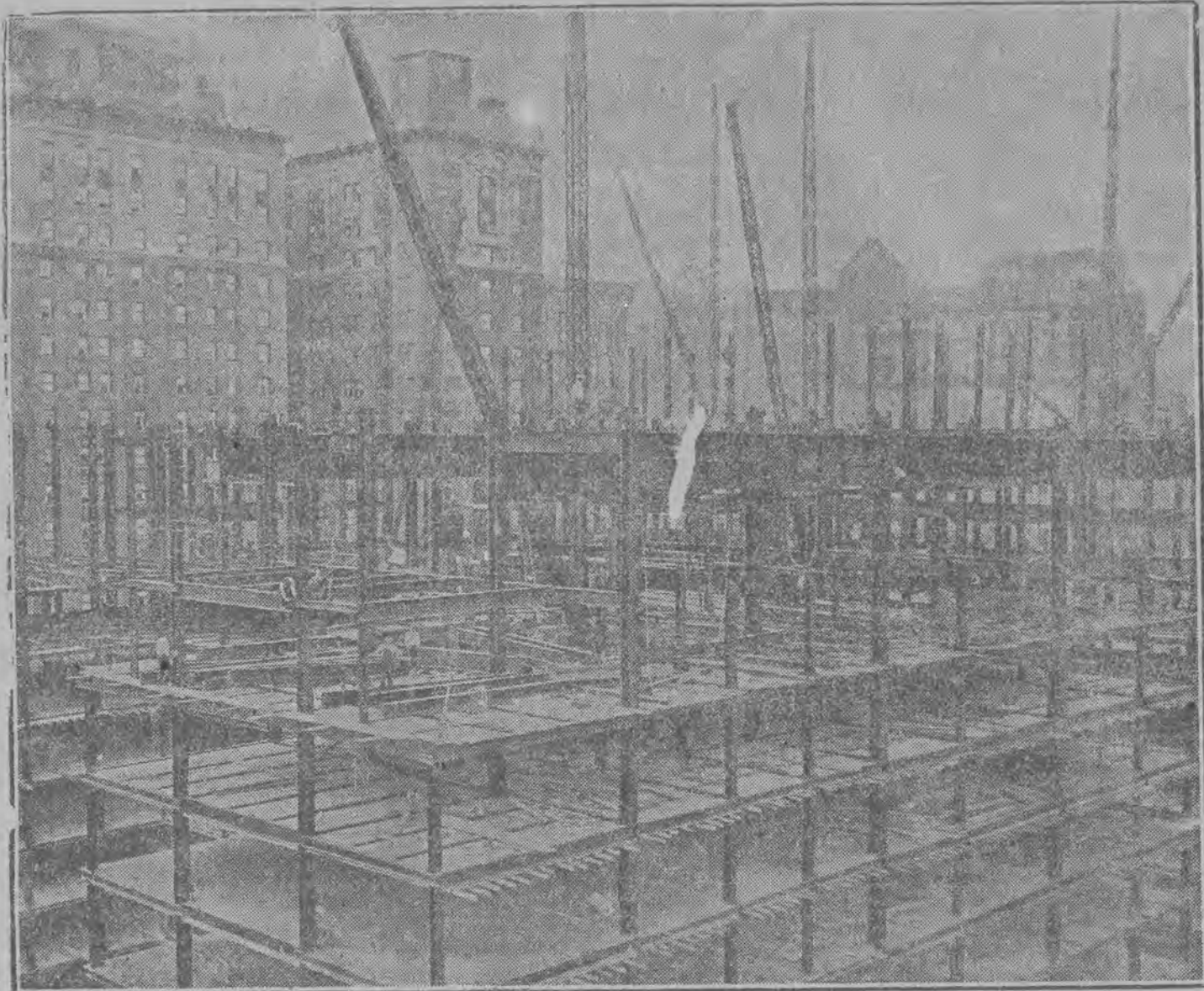
! Nasza ilustracja daje odpowiedź na zagadnienie, jak się buduje w Ameryce drapacze nieba. Ustawia się przede wszystkim stalowe rusztowanie, sprzęgnięte nastaje. Później zaś wypełnia się cementem przestrzeń na główne ściany. Drapacz nieba, obecnie stawiany, liczyć będzie 30 pięter, obliczonych na zamieszkanie 13 i pół tys. ludzi.
