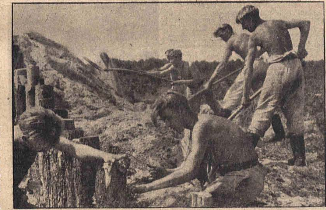
RAD. baut an der westfranzösischen Atlantikküste. Arbeitsmänner beim Bau einer Pakstellung mit Unterstand. Dicke Baumstämme werden zum Schutz der Stellung eingegraben.
