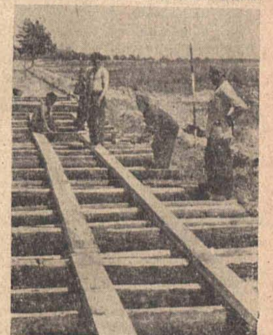
Eine Straße aus Holz Zuerst wird eine feste Unterlage geschaffen und dann werden die Bohlen aufgelegt. So entsteht die Holzstraße, und Räderfahrzeuge können den Nachschub laufend garantieren (PK-Aufn.: Kriegsberichtler Kocher, PBZ., Z.)
