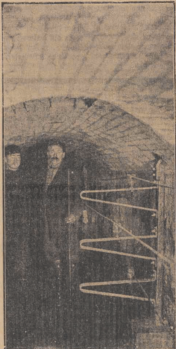
Tunele dla kabli.
