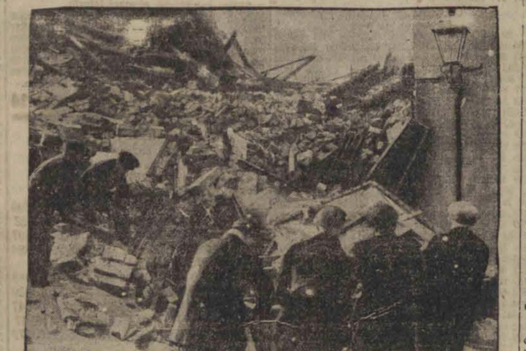
W porcie Hull (Wschodnia Anglja) zawałił się sześciopiętrowy gmach magazynu. Pod gruzami 9 robotników poniosło śmierć, 12 odniosło ciężkie rany.
