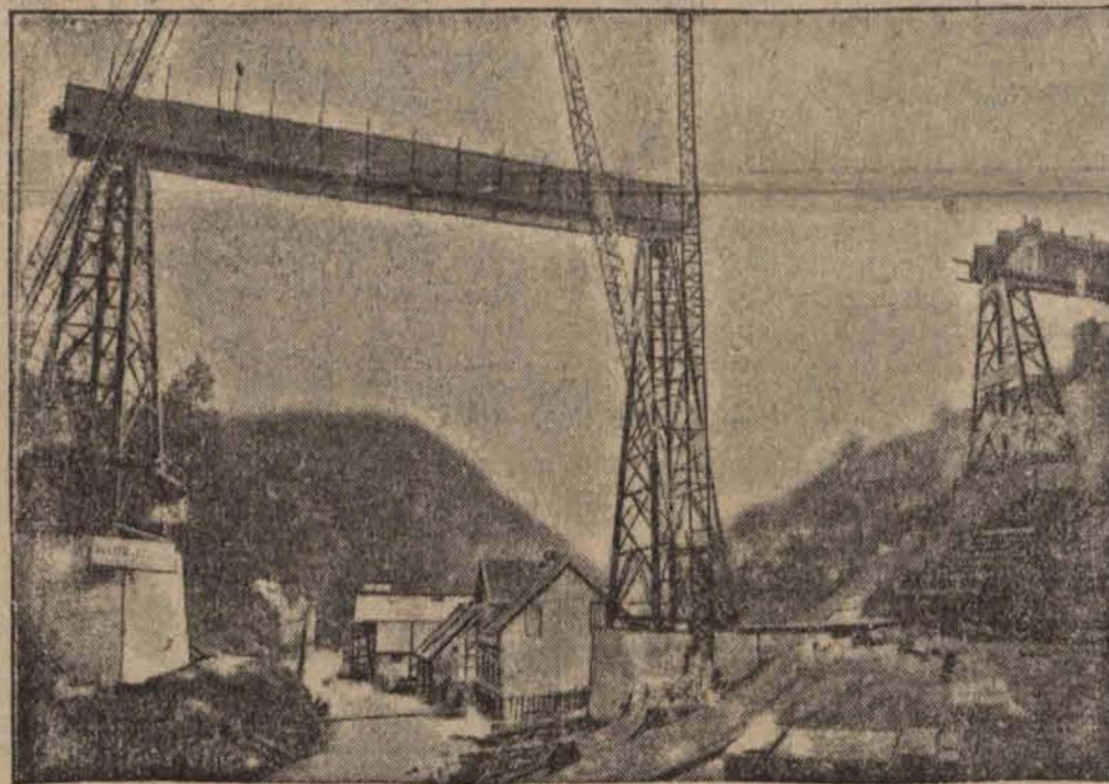
Jest już na ukończeniu. Oto budowa jednego z przęseł, tej „napowietrznej” kolei.
