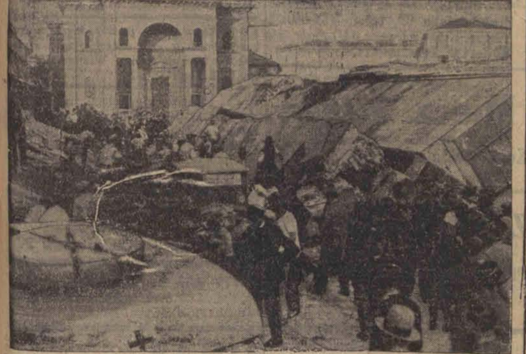
Podczas rozbiórki mostu ulicznego w Medjolanie olbrzymie masy betonu runęły, przyczem sześciu przechodniów poniosło śmierć.
