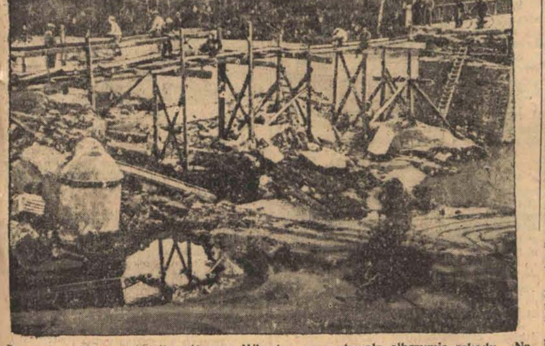
Powódź, która nawiedziła północne Włochy, spowodowała olbrzymie szkody. Na zdjęciu zniszczony most betonowy na rzece Bormida po opadnięciu wód
