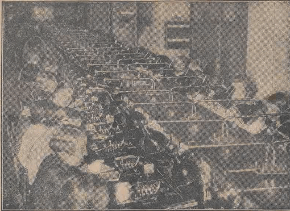
Na zdjęciu widzimy centralę telefoniczną, urządzoną według ostatnich wymogów techniki. Widok doprawdy imponujący.
