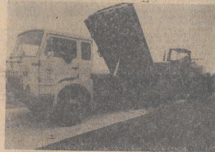
Trwa modernizacja drogi E-16 na odcinku Łódź — Piotrków Trybunalski. Obecnie prowadzi się roboty przy budowie drugiej jezdni z Łodzi do Tuszyna. CAF — Zbraniecki — telefoto
