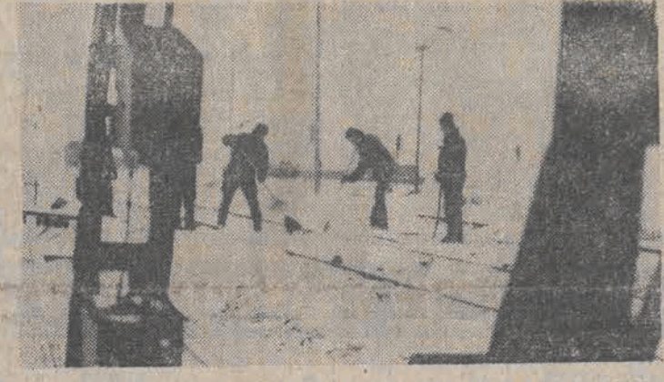
Pracownicy PKP w Zielonej Górze mimo trudnych zimowych warunków czynią wszystko, aby pociągi z węglem i innymi surowcami mogły planowo docierać do miejsc przeznaczenia. Na zdjęciu: odśnieżanie zwrótnie na stacji kolejowej Czerwieńsk. CAF — Gawałkiewicz — telefot
