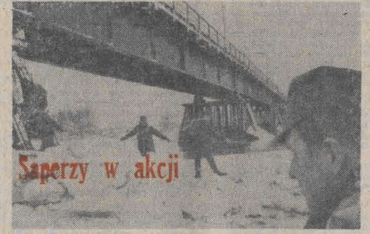
Saperzy w akcji Na niektórych odcinkach Wisły obserwuje się ruch pokrywy lodowej. Lokalne spiętrzenia lodów spowodowały uszkodzenie drewnianego mostu drogowego na Wiśle w rejonie Dębina, który został zamknięty dla ruchu. Grupa żołnierzy wojsk inżynierskich wysadza tam lodowy zator zapobiegając zniszczeniu mostu. CAF - Kwiatkowski - telefoto
