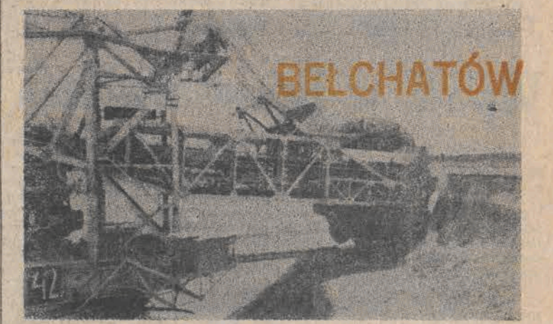
Dwa lata temu pierwsza koparka rozpoczęła zdejmowanie nadkładu w belchatowskiej odkrywcze węgla brunatnego. Dziś pracują dwie koparki, a wkrótce rozpocznie usuwanie ziem trzecia N/z: zbieranie nadkładu. CAF - Rozmysłowicz - telefoto
