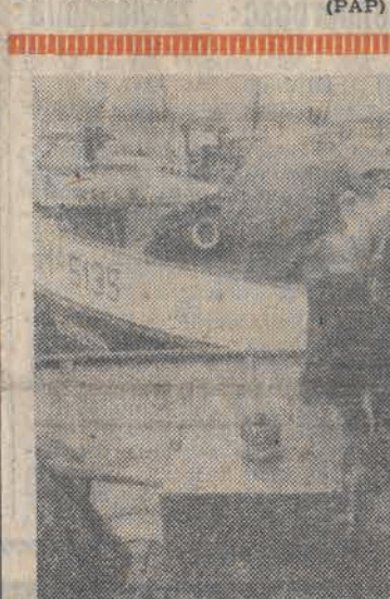
Równoległe z trwającą jeszcze żegluga, trwają remonty bieżące barki „Żegluga na Odrze”. Ponadto remontuje się barki na konto przyszłego sezonu. N/z: remont jednej z barki. Przy pracy Mieczysław Szarański i Mieczysław Kubicki. CAF — A. Hawalej
