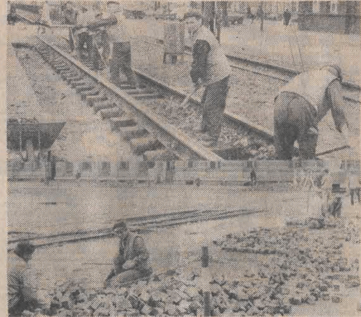
Na zdjęciu: na żołnierzy łódzkie społeczeństwo zawsze może liczyć. Tym razem służą oni pomocą hufcom MPK, przebudowującym węzeł Zielona - Zachodnia - Kościuszki.
