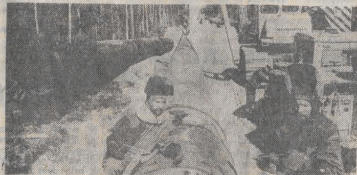
Budowniczości odcinka gazociągu Urengoj — Centrum 2 w Maryjskiej ASRR postanowili ukończyć go wcześniej, do końca roku. Każdego dnia zostaje ułożony ponad kilometr rur. CAF — TASS
