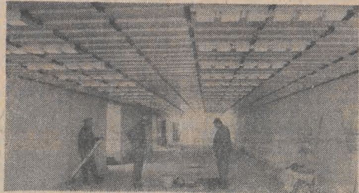
Dobiegły końca prace przy budowie kolejnego przejścia podziemnego przy al. Mickiewicza. Znajduje się ono na wysokości WZPB 1 Maja.
