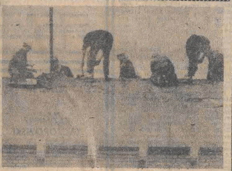
Po śmierci zbrodniarza hitlerowskiego Rudolfa Hessa, który był jedynym więźniem więzienia Spandau, przystąpiono do rozbiórki tego budynku. CAF — EPA
