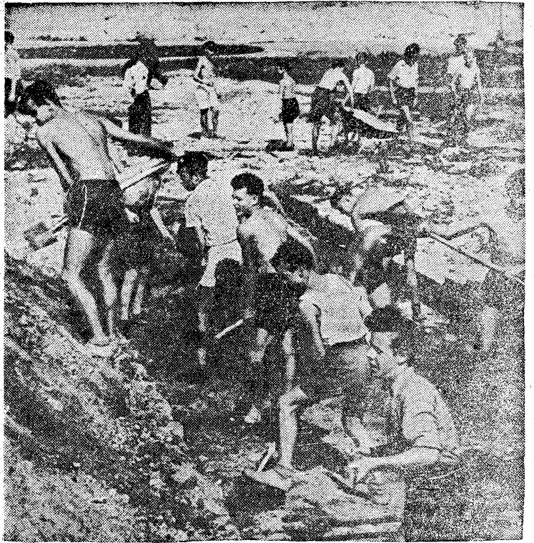
Harcerze i młodzież szkół Łodzi pracuje przy robotach ziemnych przy ul. Nowomiejskiej gdzie ma powstać sześciopiętrowy pas skwerów. (fot. J. Piżewski)
