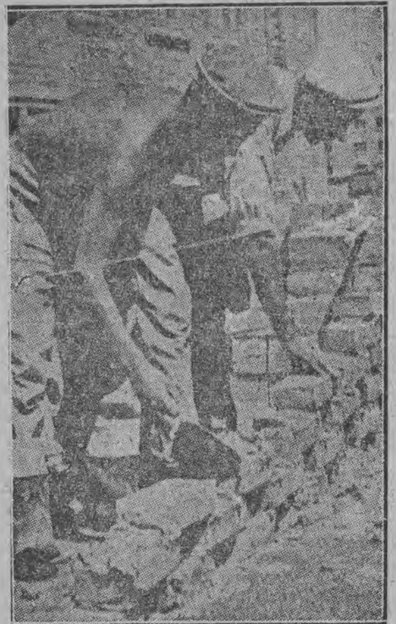
Murarz Zenon Stanisławski i podręczny Teofil Witkowski przy budowie kawiarni na Muranowie.
