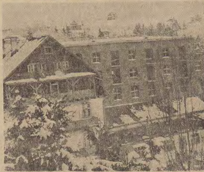
Za kilka tygodni będzie gotowe nowe skrzydło gmachu sanatorium. Stary budynek widoczny na pierwszym planie ulegnie rozbiórce.
