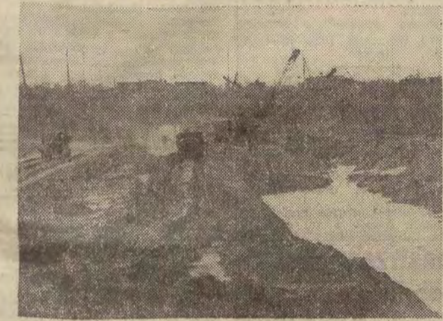
Na zdjęciu: prace przy wykopach pod silownię we Włocławku. CAF - fot. Langda
