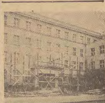
Przed kilkanaście dni przed frontem stały jeszcze rusztowania. Ale dzisiaj szkoła przy ul. Wólczńskiej w Łodzi jest już gotowa na przyjęcie wesołej, opalanej, pełnej sił do nauki młodzieży.
