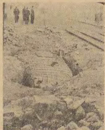
Oto skutki niwelowania ter- renu. Przedem założono w tzw. studzienkę z kablami. Maszyna niwelująca wyko- pała urządzenia kabl: tele- fonicznych.
