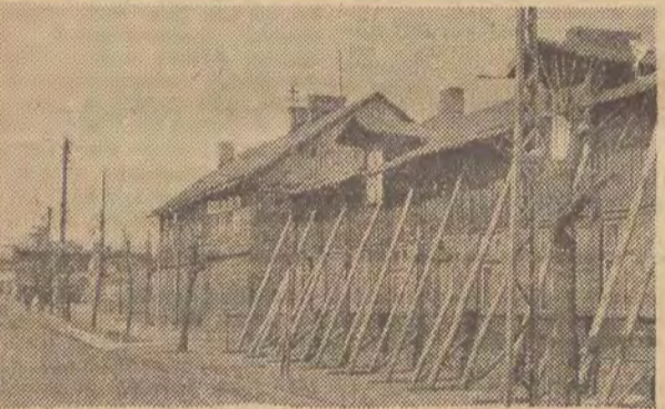
A oto jeden z chojńskich, starych domków. Wali się. Kruche ściany trzeba podtrzymywać stęplami. Wypada nareszcie pomyśleć o rozsądnym zaplanowaniu remontów wysłużonych domków na peryferiach — zanim zaczniesz im zagrazać katastrofa. Wiadomo przecież, że nie wszędzie od razu można wybudować nowoczesne bloki mieszkalne.
