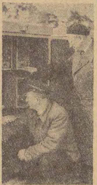
W tej szafce mieści się „mózg” automatycznego dróżnika
