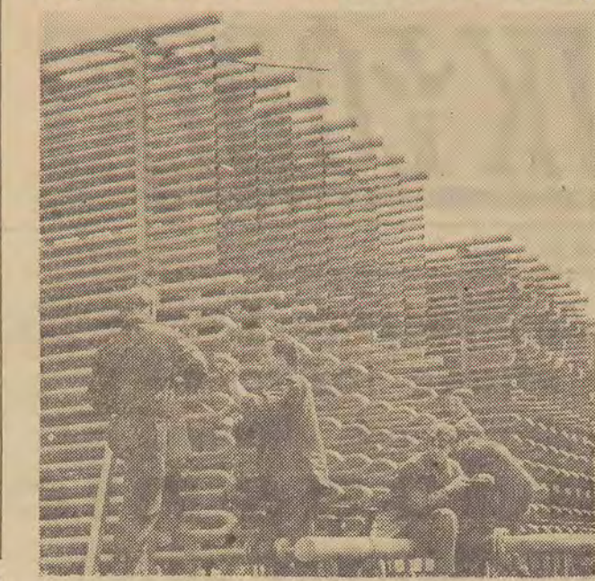
Wkrótce zostanie uruchomiona w Łodzi wielka chłodnia, której koszt szacuje się na około 46 milionów złotych. W komorach nowej chłodni będzie można przechowywać kilkadziesiąt ton mięsa. Chłodnia będzie zapleczem dla największej w kraju rzeźni łódzkiej. — Na zdjęciu: montaż wielkich skraplaczy. CAF — Fot. Puclat
