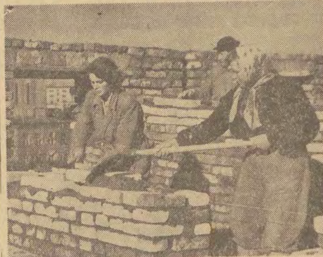
Na terenie budowy osiedla mieszkaniowego — Warszawa-Koło pracują między innymi dwie przodujące murarki: Józefa Tratkiewicz i Halina Ber. Wykonują one przeciętnie 300 proc. normy.
