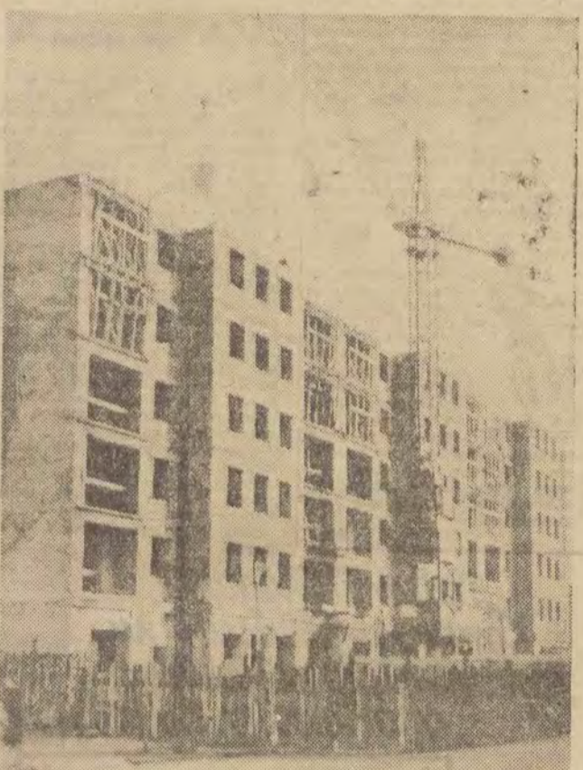
...Na budowie trwają intensywne prace. „Adaś” w tej właśnie chwili wznosi na swym stalowym ramieniu zaprawę betonarską. Foto: L. Olejniczak
