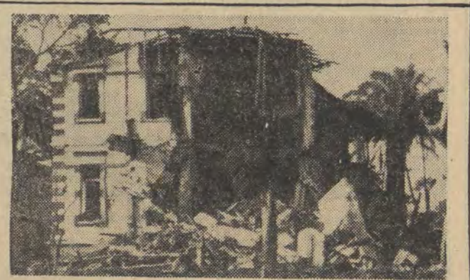
Jeden z budynków w Suezie zniszczony w dniu 15 lipca ogniem z baterii izraelskich położonych po wschodniej stronie Kanalu Sueskiego. Była to kolejna prowokacja zbrojna, jakiej dopuścił się Izrael wbrew przyjętym zobowiązaniom oraz decyzjom. CAF — Unifax
