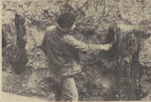
Na zdjęciu: odsłonięte pale umacniające brzeg Łódki.
