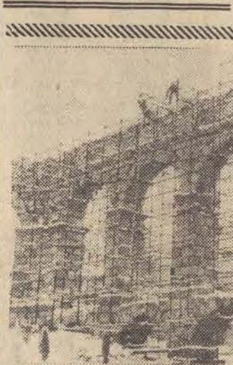
Słynne akwedukty zbudowane w Segovii (Hiszpania) przez Rzymian doczekały się konserwacji. Na razie ukryte w gęstwinie metalowych rusztowań, na wiosnę będą „jak nowe”. CAF — Cifra
