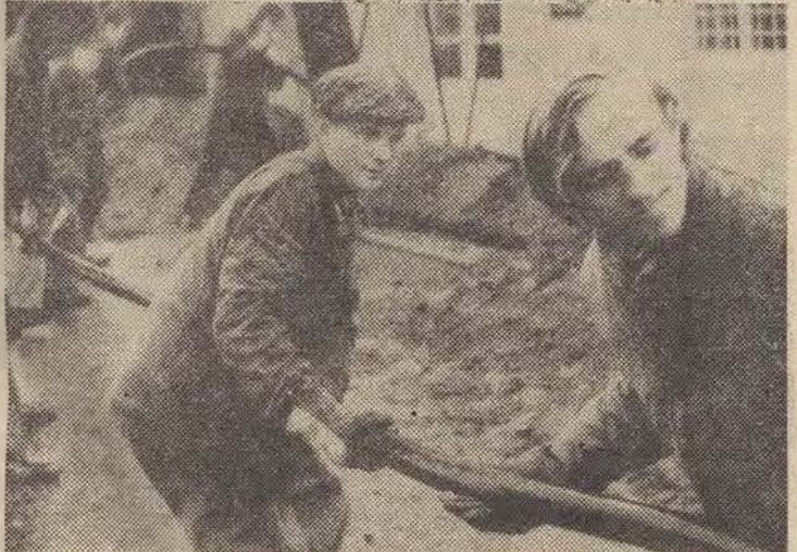
Młodzi aktywiści z „Eity” pracowali na wielu frontach. Na zdjęciu prace przy układaniu kabli elektrycznych.
