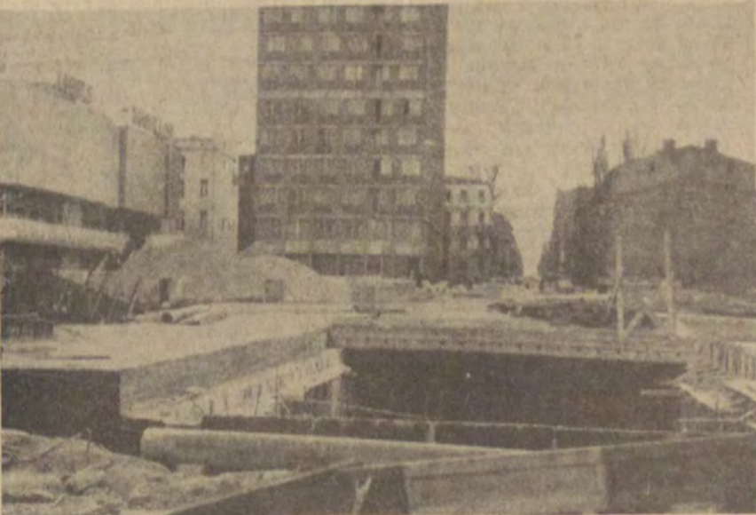
Ostatnia faza budowy przejścia podziemnego na Sienkiewicza. Zakończenie robót konstrukcyjnych umożliwiło zamknięcie ul. Piotrkowskiej.
