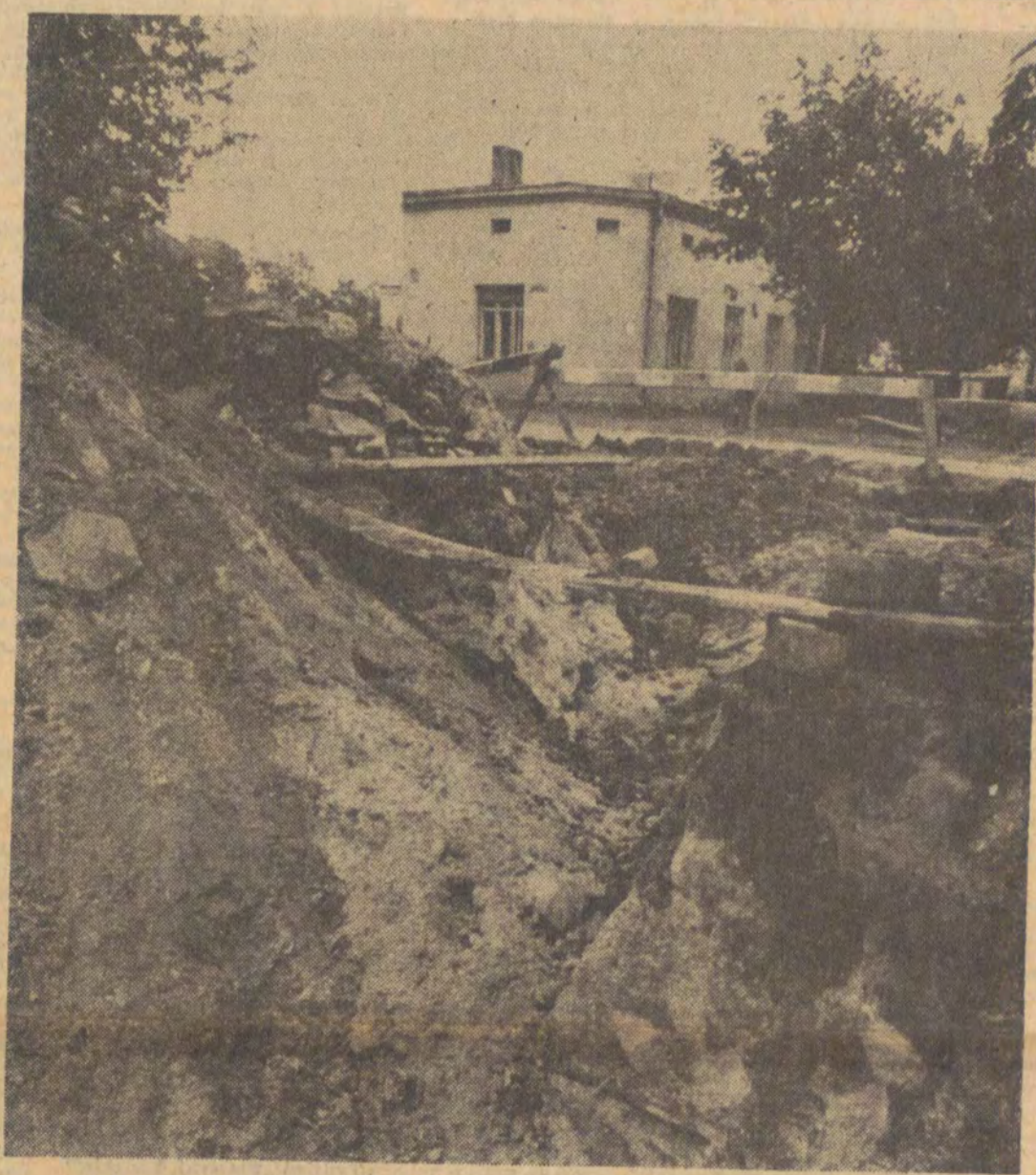
„Nie ogrodzony, jeszcze wciąż powiększany plac budowy sięga pod ściany kilku domów, w których wciąż jeszcze żyją ludzie”.
