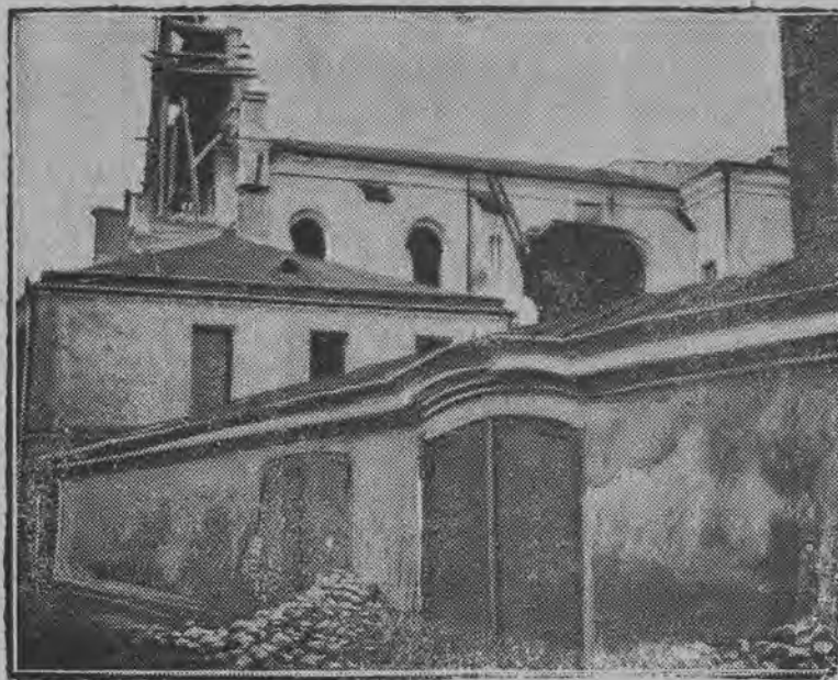
Widok na kościół z uliczki św. Ignacego w Wilnie, przy którego odbudowie wydarzyła się katastrofa. Oto osunął się filar, podtrzymujący nawę główną, skutkiem czego część sklepienia runęła.
