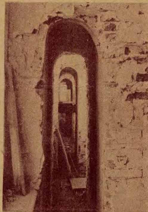
Podczas prac przy odnawianiu odnaleziono zamurwane przez Rosjan przejście, służące jako korytarz Wielkiej Sali Sejmowej.
