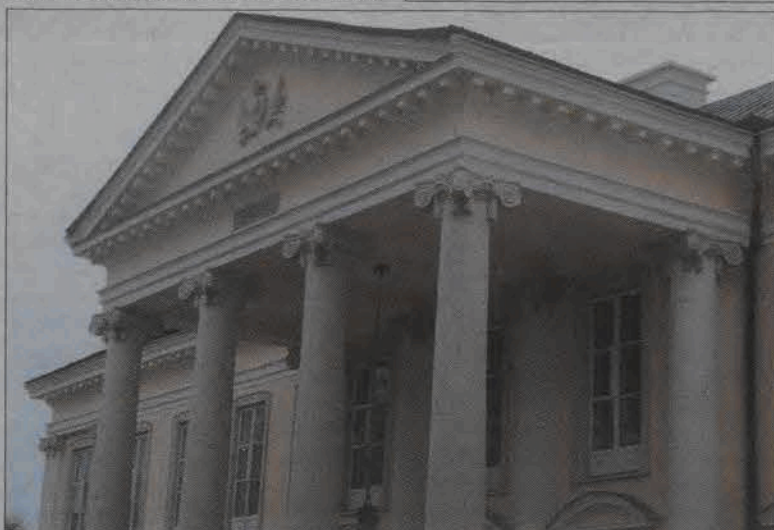
Sporzenie na górne fragmenty frontonu walewickiego pałacu daje pojęcie o precyzji prac, jakich podejmowała się ekipa konserwatorów.
