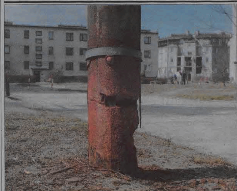
Aż cud, że ten słup oświetleniowy na osiedlu Szarych Szeregów jeszcze stoi. Wystarczy się oń oprzeć, a już wydaje dziwne dźwięki gotów złamać się jak zapalka. Jego podstawa jest przeżarta rdzą, a przewody energetyczne nie są już niczym osłonięte. Zaledwie 10 metrów dalej znajduje się plac zabaw, na którym nigdy nie brakuje dzieci...
